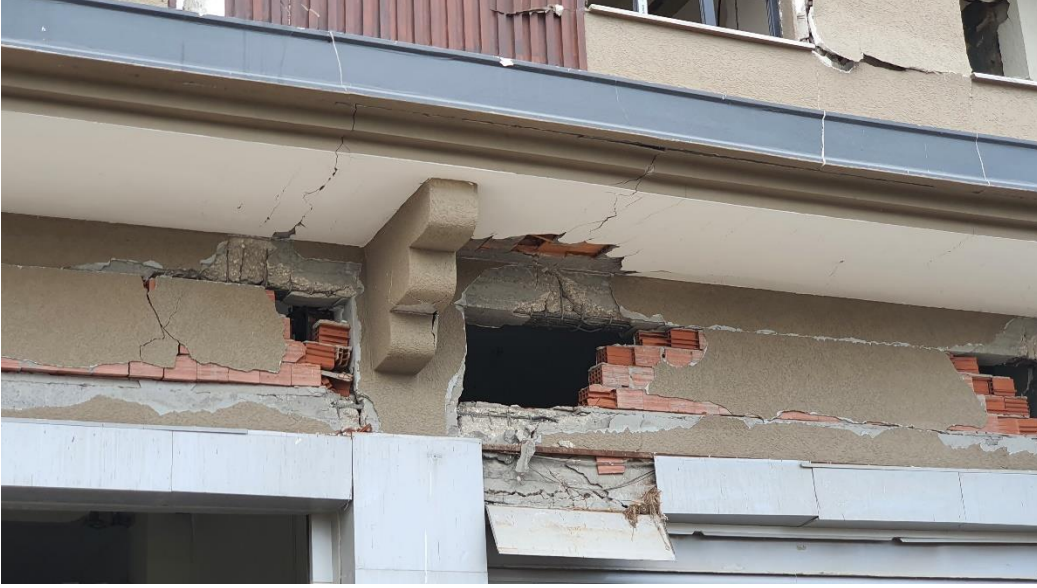
Şekil 12. Kısa Kolon Hasarı
