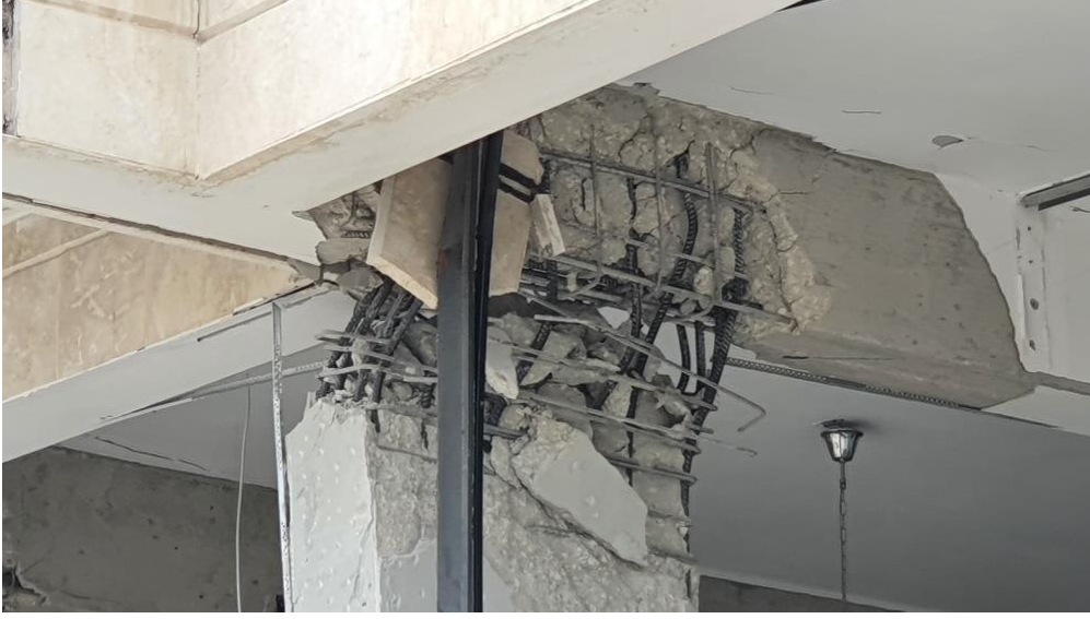
Şekil 10. Ağır Hasarlı Kolon-Kiriş Birleşimi
