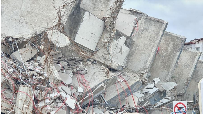
Şekil 8. Devrilmiş Bir Yapı
